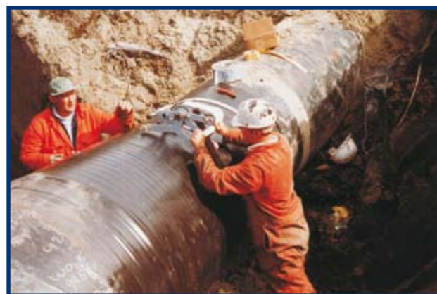
Bescherming van de veldlassen en bochten in fabrieksmatig belkede buizen.
